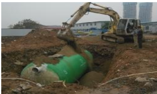
图 5-4 施工营地化粪池
